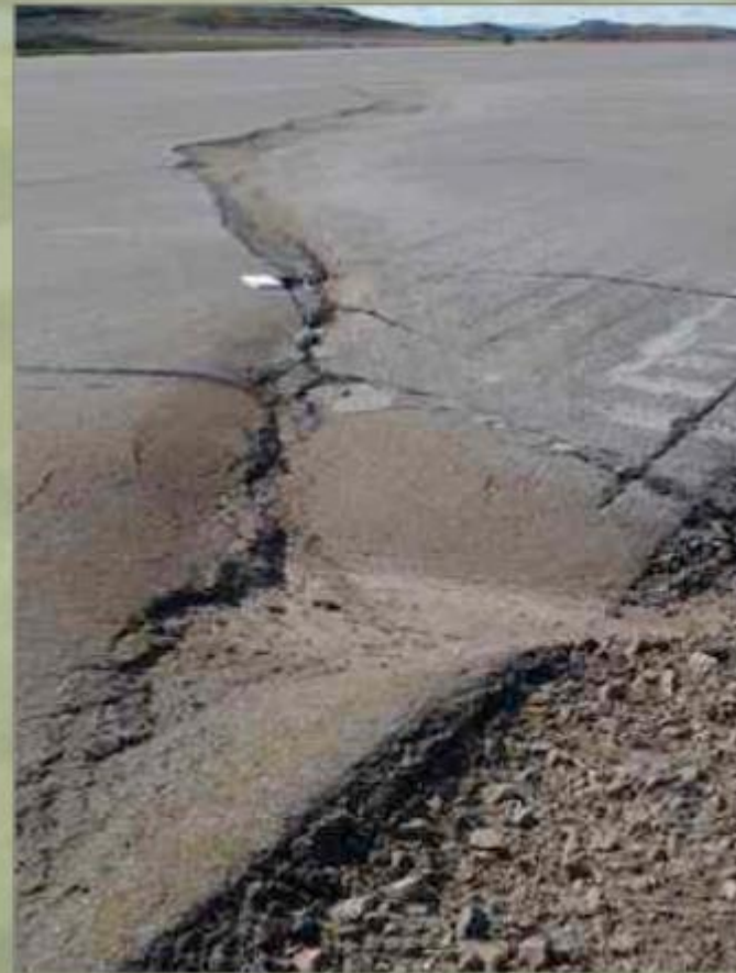
2. Tassements linéaires au droit de coins de glace en dégradation
