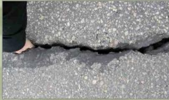
1. Fissures de contraction thermique
