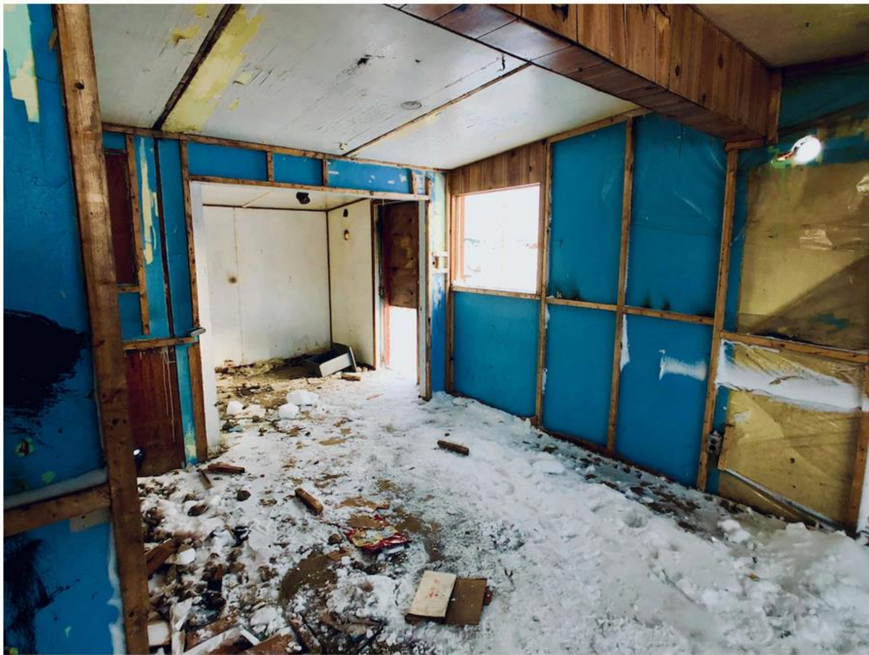
Une maison qui a dû être condamnée par les autorités dans la communauté insulaire de Qikiqtarjuaq. Photos : Radio-Canada/Marc Godbout
