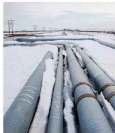
De nombreuses fuites sur le pipeline trans-Alaska
